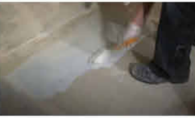
2. Нанести підготовлений гідроізоляційний матеріал SKALASTIC-220 W з обох боків шову підлого-стіни, стіни-стіни, залишаючи приблизно по 10 мм з кожної сторони вільними від розчину. По стіні гідроізоляцію дати на висоту 300мм від рівня покриття підлоги.
