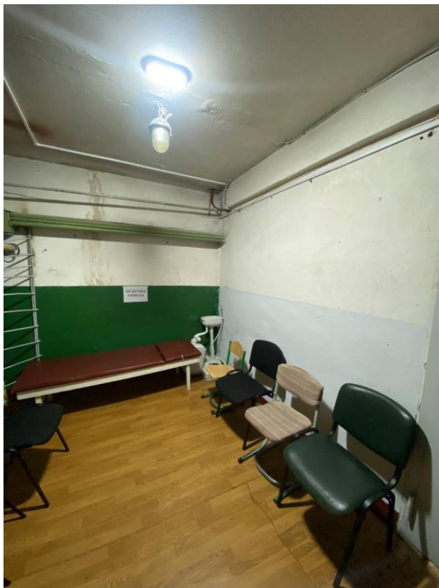
Фото 5. Підвальне приміщення. Часткове руйнування опорядження стін.
