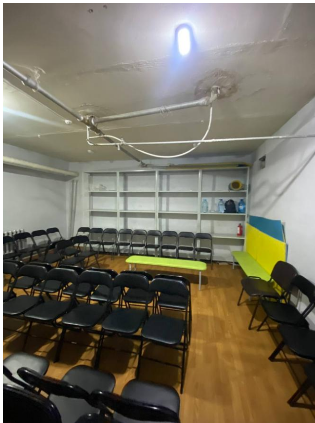
Фото 7. Підвальне приміщення. Часткове руйнування опорядження стелі.
