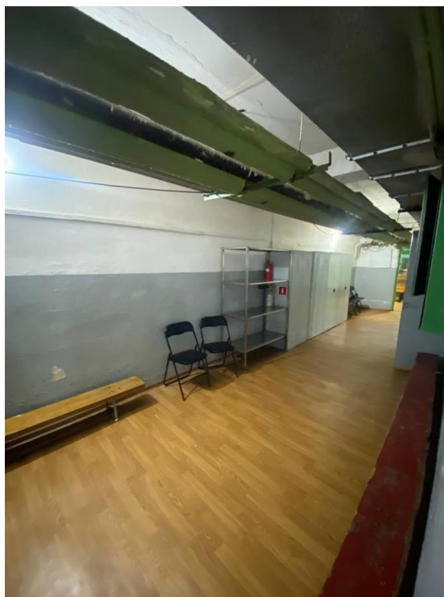
Фото 8. Підвальне приміщення. Часткове руйнування опорядження стін.
