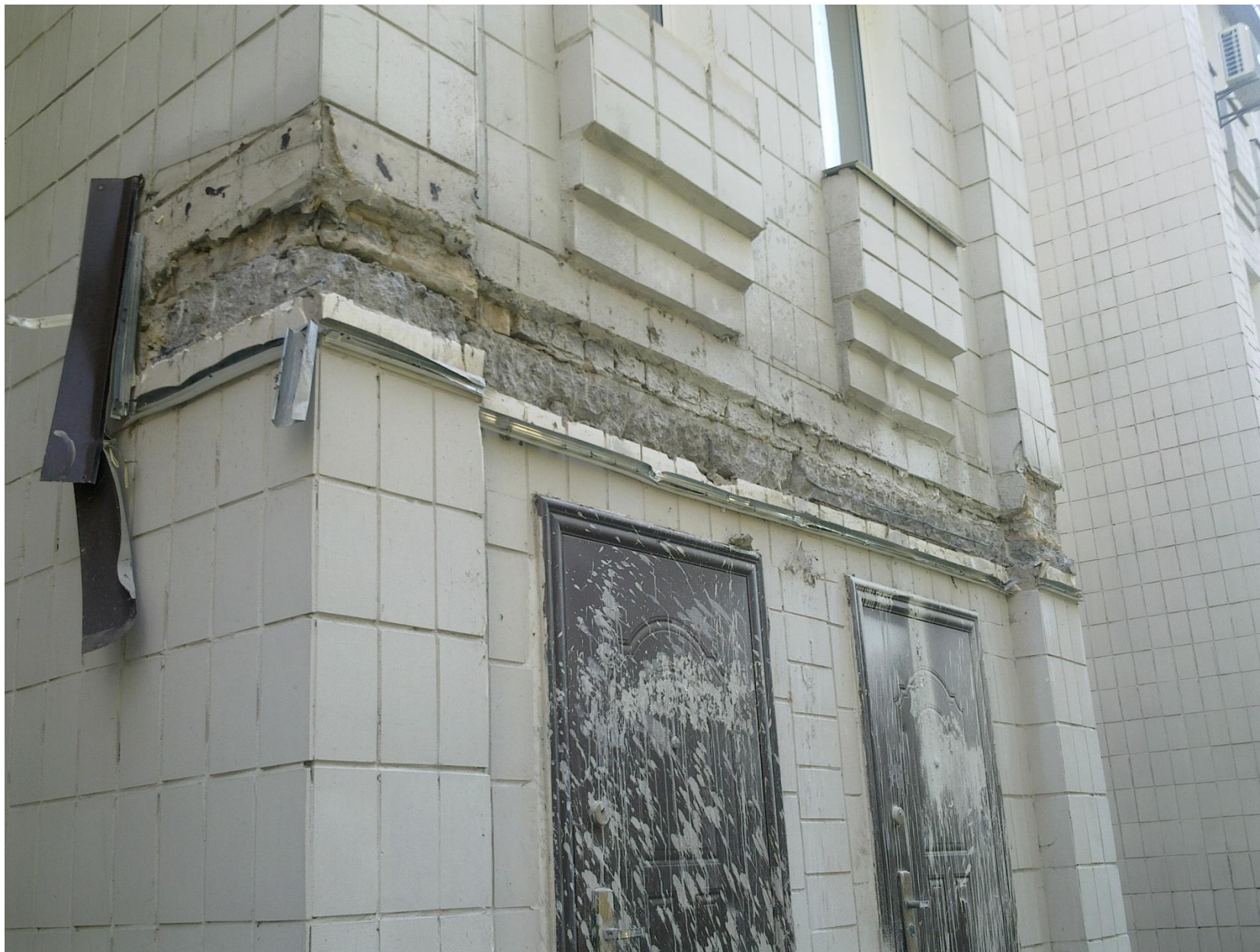
Это, дверри, которые с козырьком, ..были. козырек будет, но.... потом.
