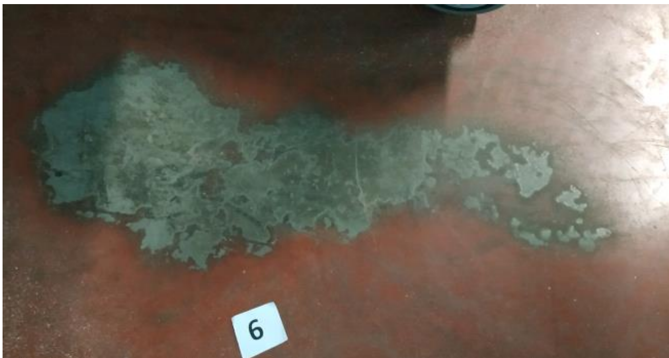
Фото пошкоджень підлоги секції №6(зона контролю)
