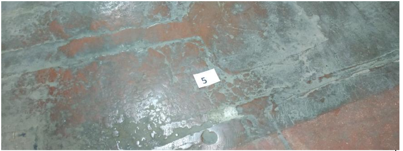
Фото пошкоджень підлоги секції №5 (зона гравітації)
