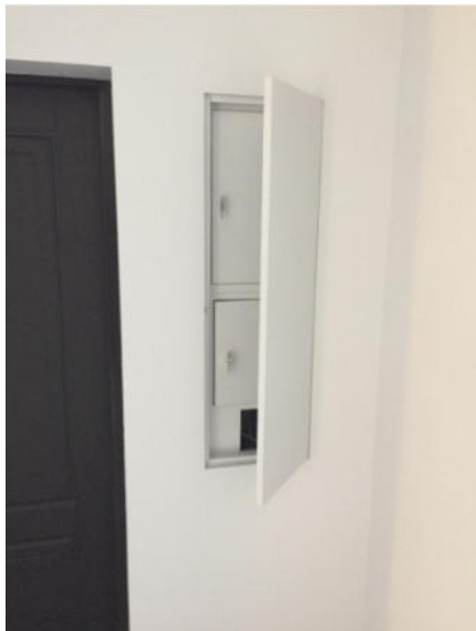
Аналог електрощитової, прихованої за ДСП на системі відкриття Push-to-open
