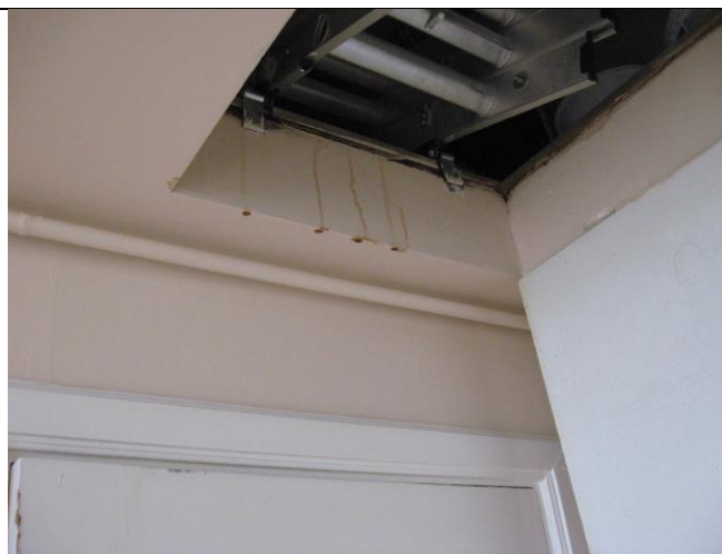
Плями від залиття, тріщини, руйнування гіпсокартону стін верхньої частини ванної кімнати, іржа на кутнику країв отвору дверцят до верхньої частини ванної кімнати
