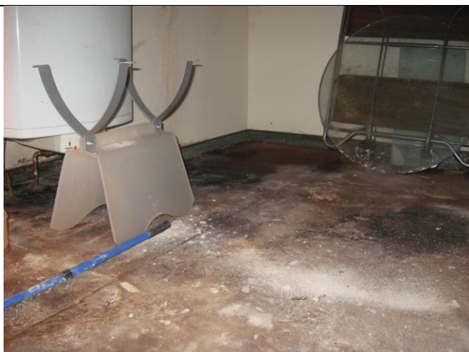
Плями від залиття, тріщини, руйнування гіпсокартону стін, здуття ДСП підлоги, пошкодження ковтроліну підлоги верхньої частини ванної кімнати
