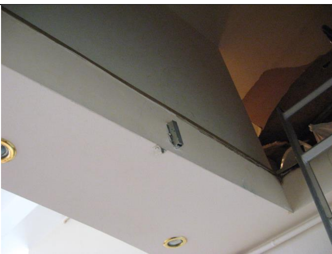
Плями від залиття, тріщини, руйнування гіпсокартону стін верхньої частини ванної кімнати
