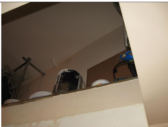
Плями від залиття, тріщини, руйнування гіпсокартону стелі та стін верхньої частини ванної кімнати
