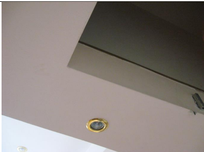
Плями від залиття, тріщини, руйнування гіпсокартону стін верхньої частини ванної кімнати
