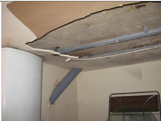
Плями від залиття, тріщини, руйнування гіпсокартону підвісної стелі верхньої частини ванної кімнати
