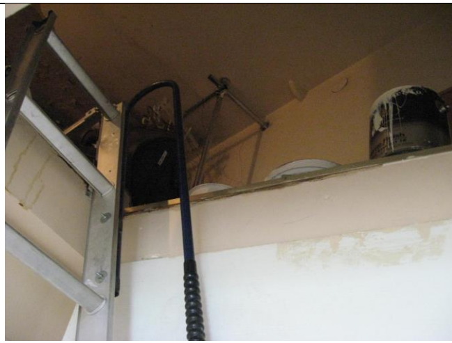
Плями від залиття, тріщини, руйнування гіпсокартону стелі та стін верхньої частини ванної кімнати
