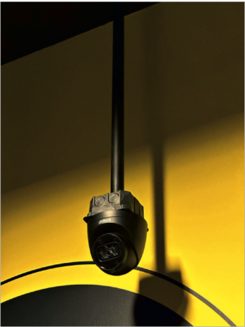
Приклад розміщення камери на меблевій трубі з розпред коробкою
